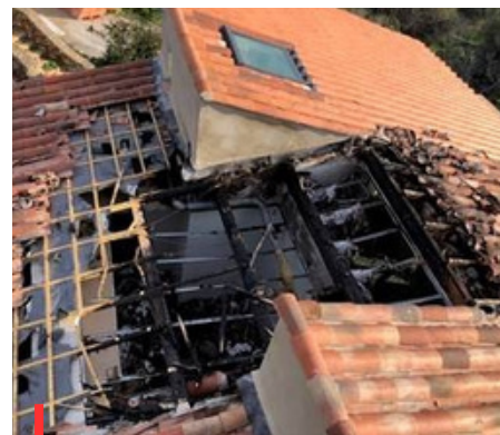
L'incendie a endommagé la toiture
